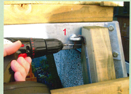
Abb. 7 Sicherung der Aufstiegsleiter
