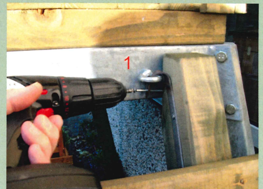
Abb. 7 Sicherung der Aufstiegsleiter
